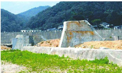
壊れた防波堤 岩手県宮古市田老
