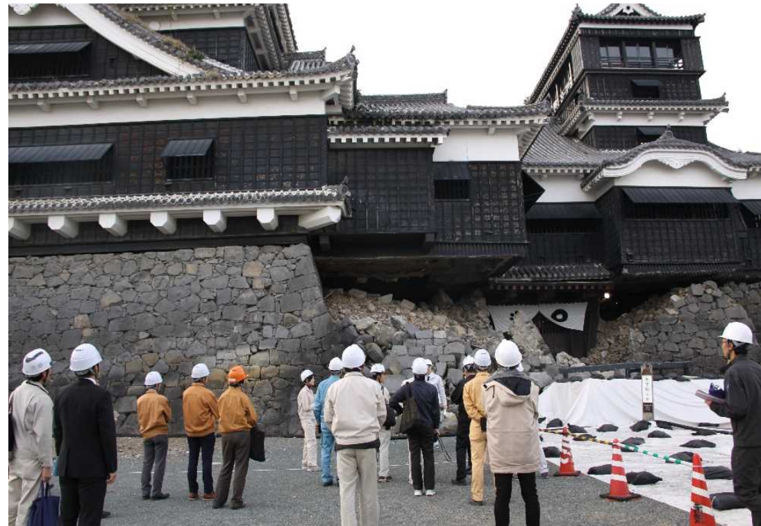
図6：熊本城における災害査定立会
