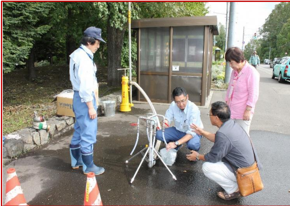
仮設給水栓① (地上式消火栓)
