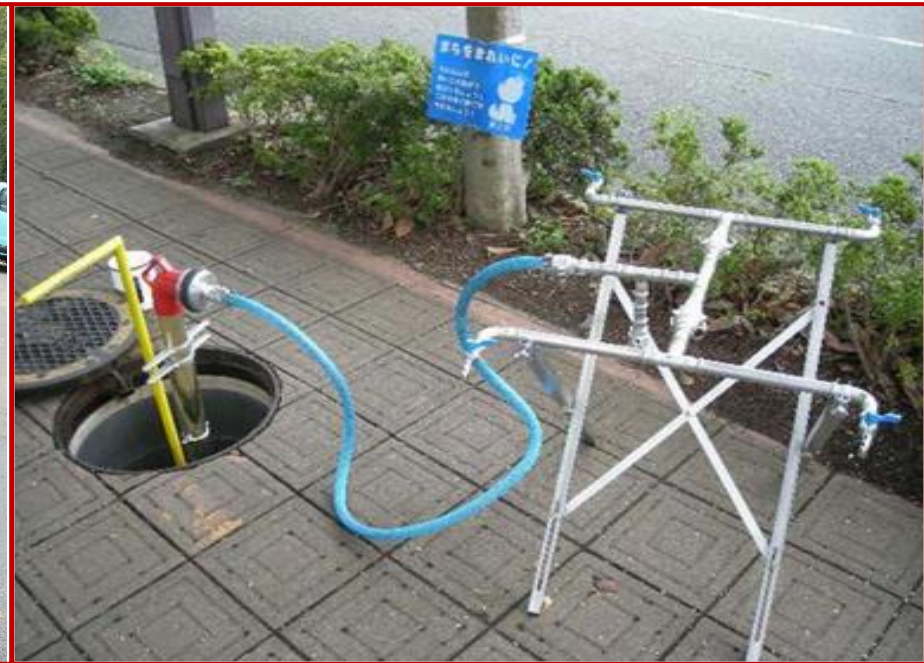
仮設給水栓② (地下式消火栓)
