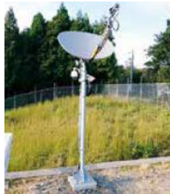
<衛星通信設備>
