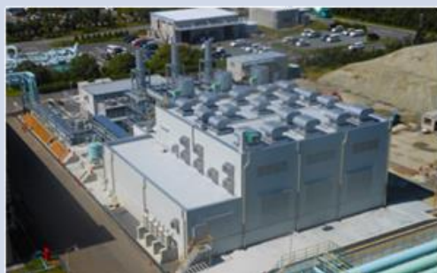
四日市発電所
