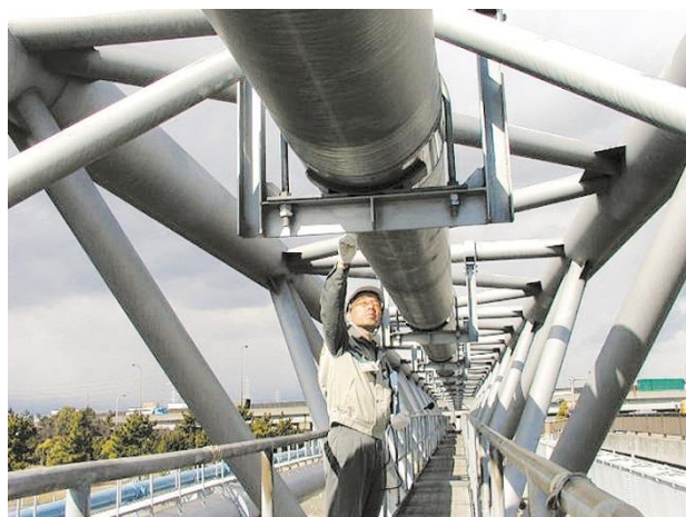
地震動に強い溶接鋼管を採用するとともに、定期点検による健全性確認を実施
