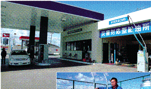
⑤災害対応型給油所の 源井上商店・大里S 下水をためる給水タン を点検する井上裕昭 長。背後はシートを った自家発電機、右側 る過装置。いずれも 県稲沢市増田北町で
