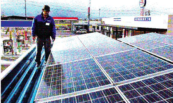
設備の屋根に設置された太陽光発電パネル＝三重県菰野町で
