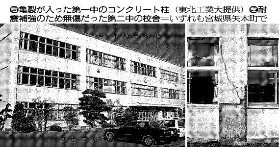
亀裂が入った第一中のコンクリート柱 (東北工業大提供) 耐震補強のため無傷だった第二中の校舎 (いずれも宮城県矢本町で)
